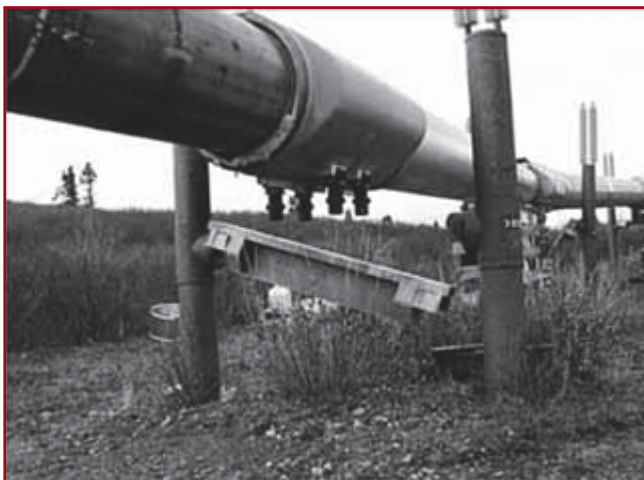
Рис.2. Разрушение термоопор в результате многолетнего пучения грунтов
