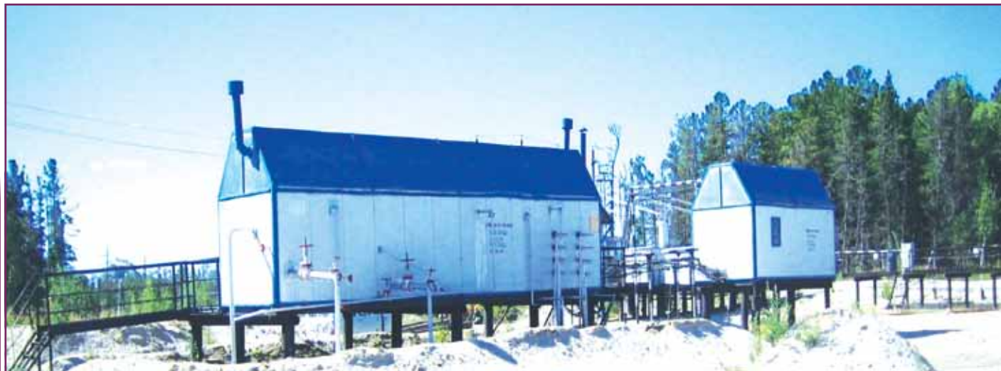
Рис.4. Фрагмент фотографии стационарной гидроприводной станции на 4-8 скважин, обустроенной на кусте скважин Самотлорского месторождения (2006 г.)
