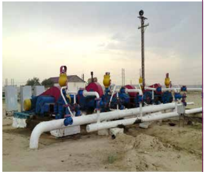
Насосы перекачки нефти НБ-125
