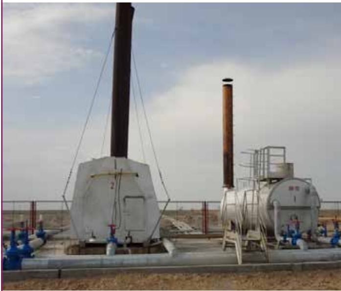
Печи подогрева нефти 1, 2 ступени
