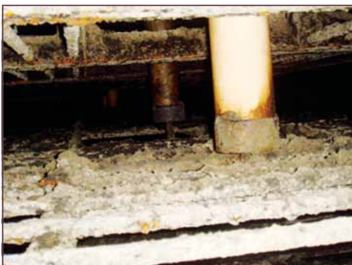
Рис.5. Нефтешлам скопившийся на электро-дегидраторе
