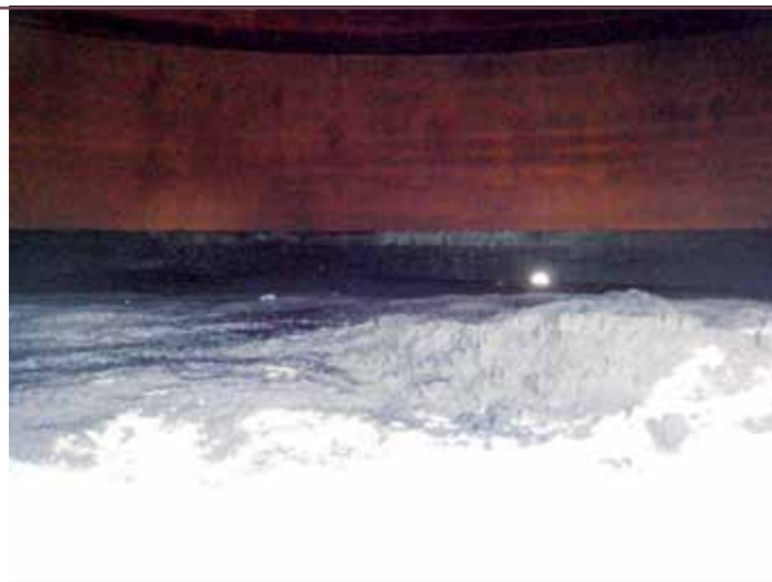
Рис.4. Нефтешлам скопившийся на днище технологического резервуара
