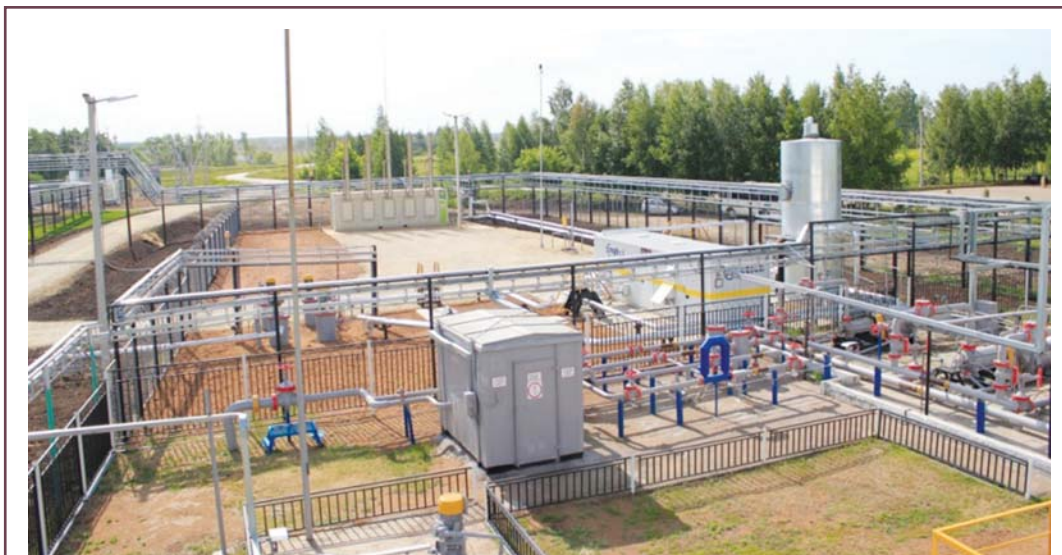
Рис.5. Газотурбинная установка CAPSTONE C-класса
